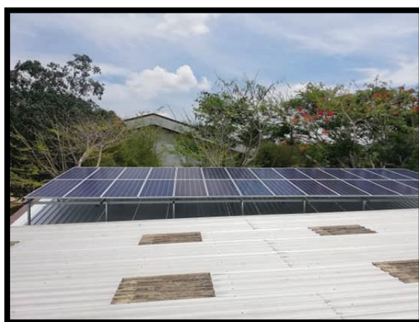
โครงการติดตั้งระบบโซลาร์เซลล์ (พลังงานแสงอาทิตย์ (Solar Cell) สำนักงาน อบต.บ้านลำนาว
